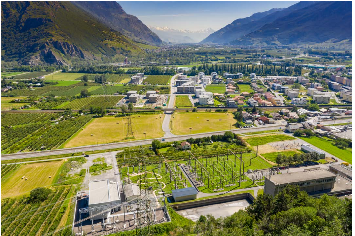
Le nouveau poste de 380 kV et le poste aérien de 220 kV à La Bâtiаз, juin 2019.
