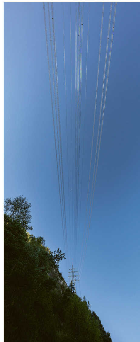
La nouvelle ligne THT Chamoson – Chippis sur les hauts de Sion
