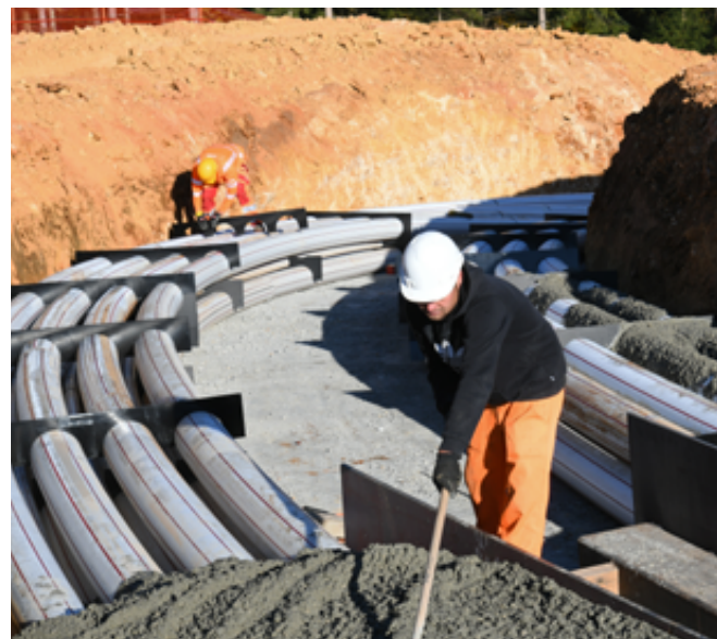
Exemple de câblage dans un bloc de tubes de câbles
