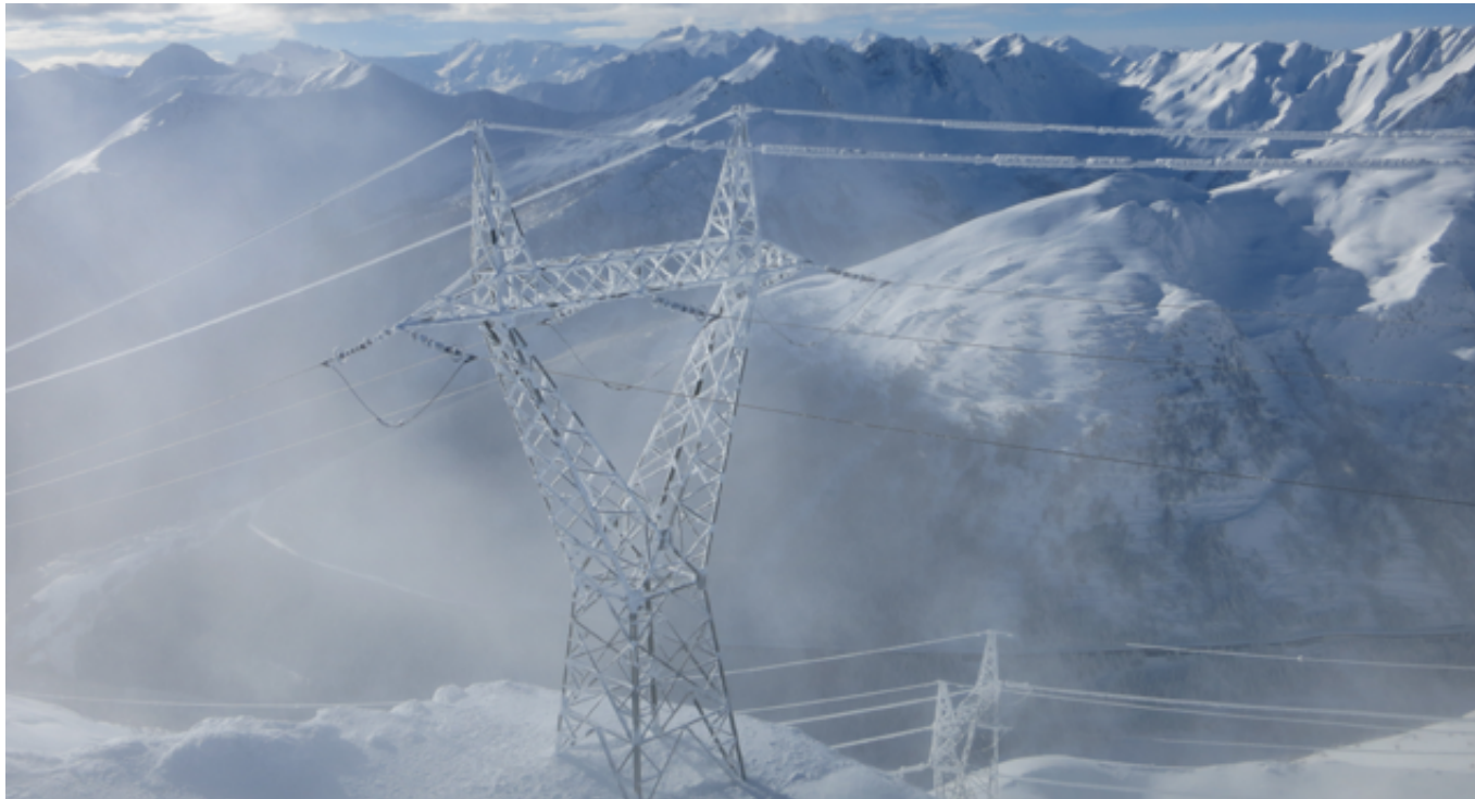
Ligne à très haute tension recouverte de neige
